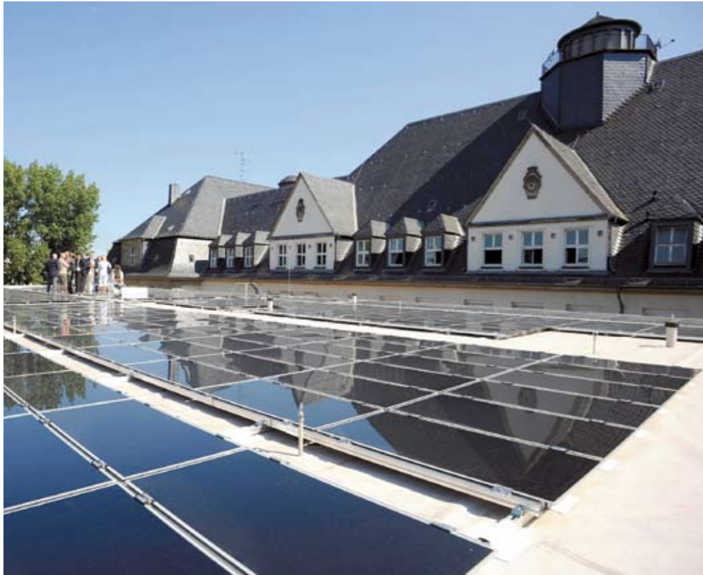
Die neue Solaranlage auf dem Dach der Elly-Heuss-Schule
