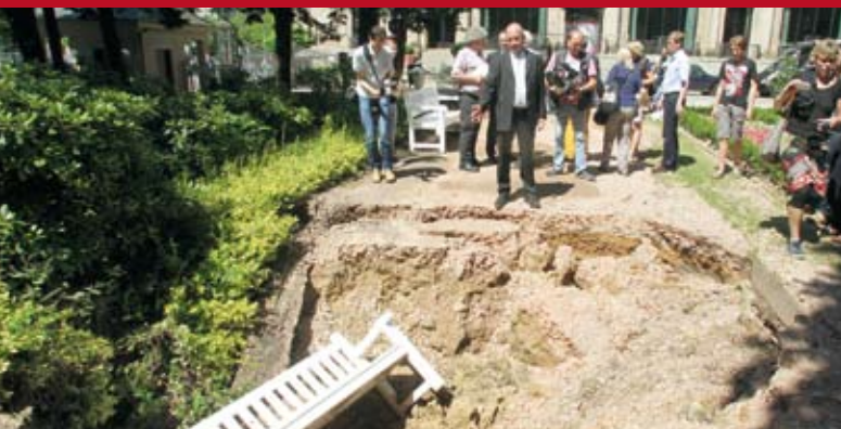
Tiefer Fall: Am Nizza-Plätzchen im Kurpark entstand durch das Hochwasser ein 1,50 Meter tiefes Loch. Hier betrieben Hydrologen Ursachenforschung. Die Unterspülungen hatten im Kurhaus-Keller die gesamte Technik lahmgelegt.
