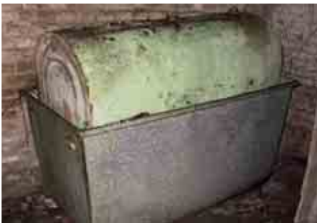
Einwandiger Heizöltank ohne ausreichende Auffangwanne; Überfüllsicherung, Entlüftungs- und Entnahmeleitungen fehlen
