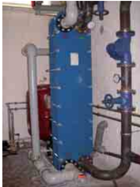
Wärmetauscher der Nahwärmeinsel Kleine Schwalbacher Straße
