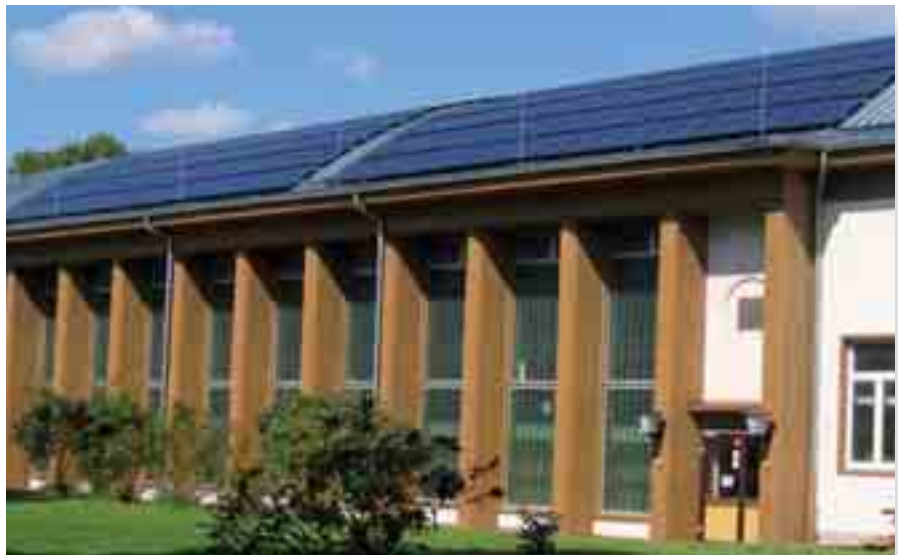
Photovoltaikanlage auf dem Dach der Sporthalle Willy-Brandt-Allee
