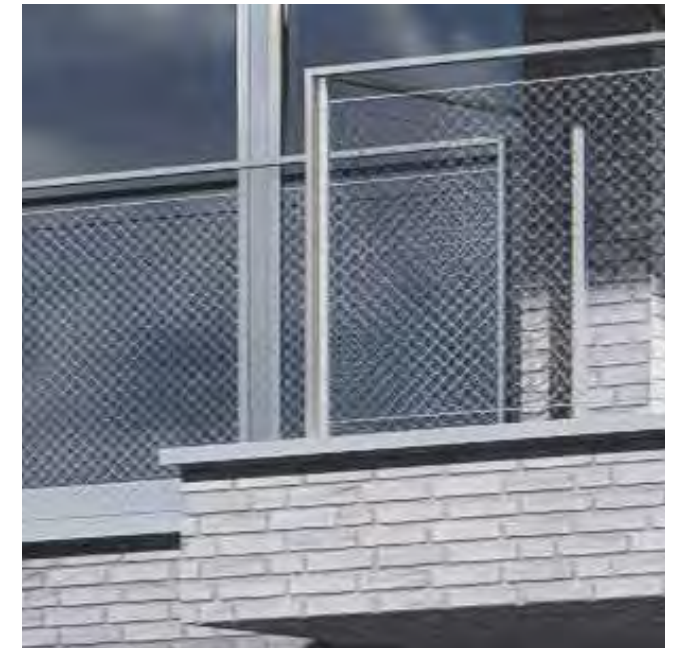
Geländer: Edelstahlseilnetz in Flachstahlrahmen
